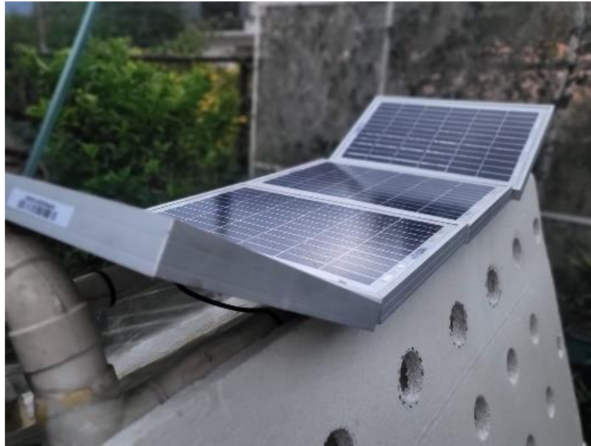
Figura 20 Paneles solares utilizados ( Elaboración propia )
