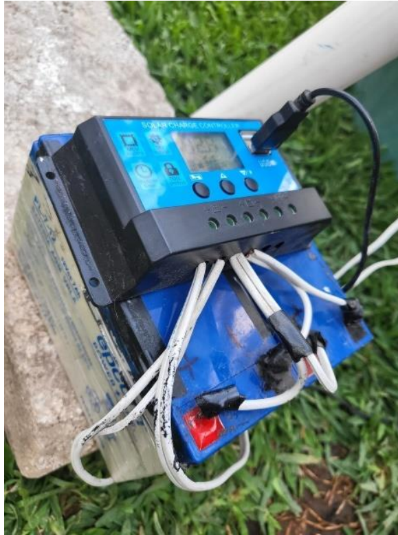
Figura 21 Arreglo de baterías con controlador ( Elaboración propia )
