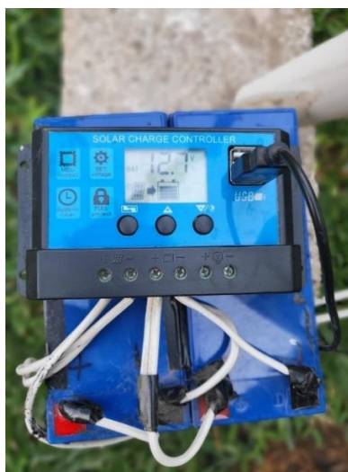
Figura 32 Centro de carga ( Elaboración propia )
