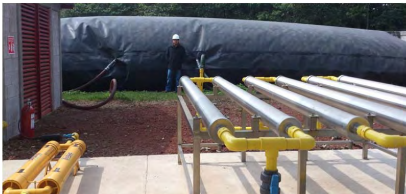
Imagen 51. Almacenamiento de biogás para su combustión con moto generador
