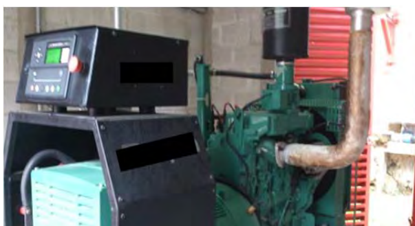
Imagen 52. Motogenerador a gas con generador eléctrico.
