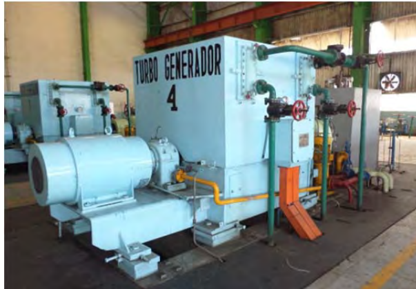
Imagen 41. Planta eléctrica (Turbogeneradores de vapor para producir energía eléctrica)
