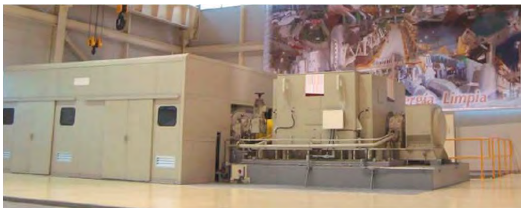
Imagen 55. Turbogenerador condensante con extracción usando bagazo o RAC
