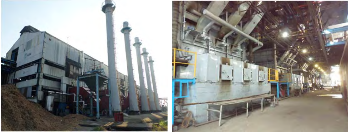
Imagen 40. Calderas de vapor de alta presión
