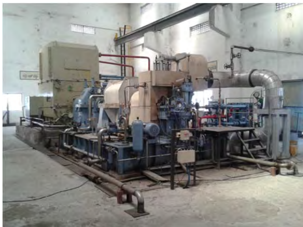
Imagen 45. Turbogenerador condensante sin extracción para la cadena de valor usando pollinaza
