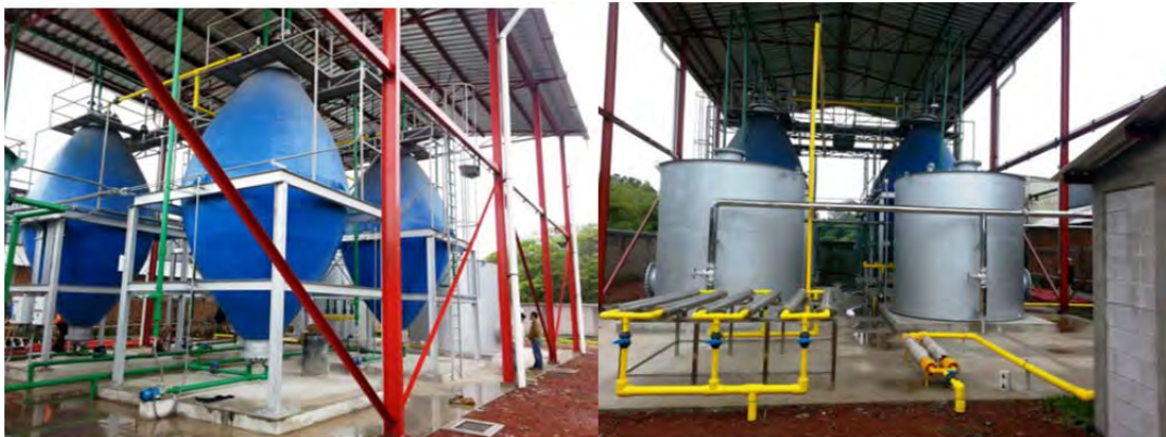
Imagen 50. Planta de digestión anaeróbica con reactores ovoides
