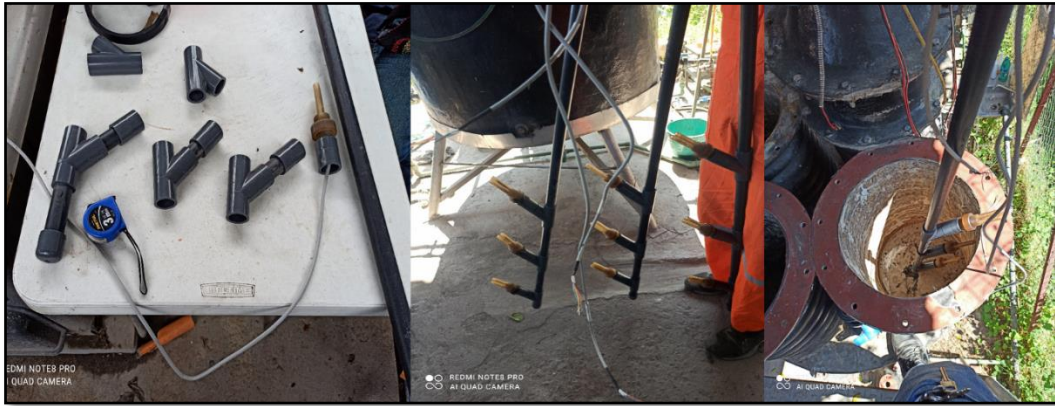
Figura 3.33 Instalación de los electrodos de conductividad eléctrica en el interior de las columnas
