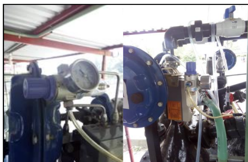
Figura 3.16 Cambio de posición de los filtros de aire en las electroválvulas
