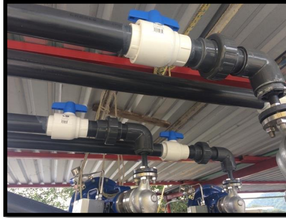
Figura 3.1 Válvulas de 2” para regulación manual de flujo
