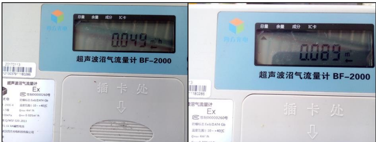
Figura 3.8 Medidor de flujo de biogás en fase 1 (izquierda) y en fase 2 (derecha)
