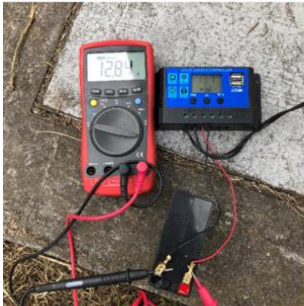
Figura 40: Controlador regulando el voltaje hacia la batería.
