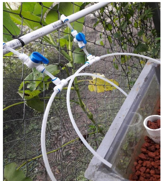
Figura 3.20 Válvulas de alimentación
