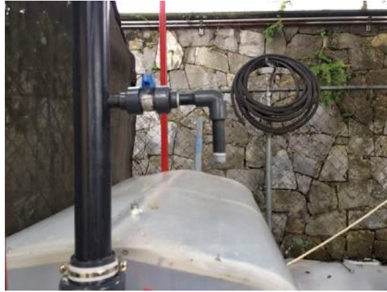
Figura 3.23 Válvula para muestra de biogás
