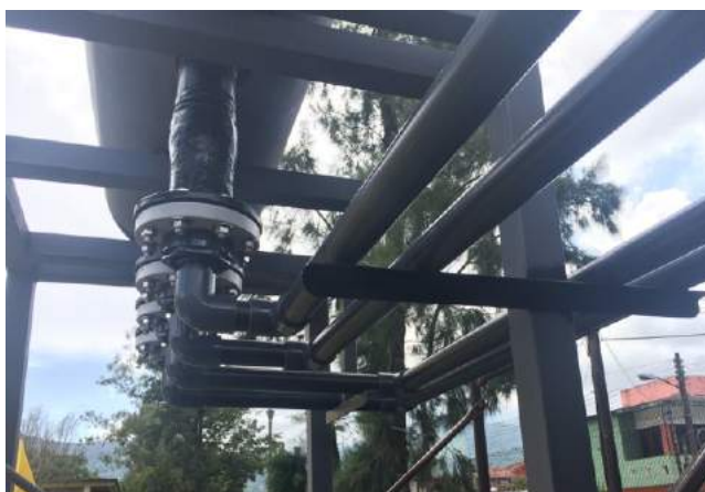
Figura 3.8 Arreglo en las líneas de distribución de sustrato
