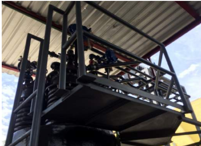
Figura 3.20 Estructura de seguridad en el RLFIAP
