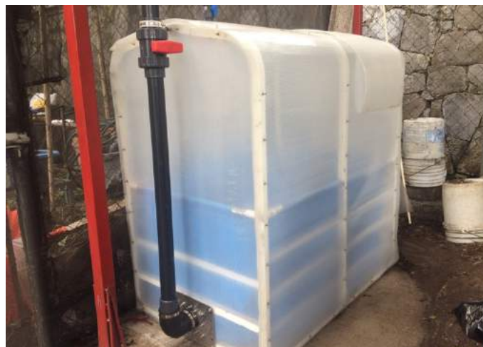
Figura 3.24 Almacenamiento de biogás
