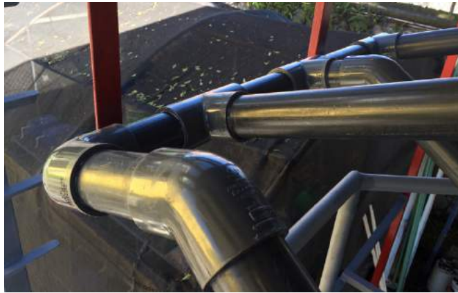
Figura 3.21 Líneas de biogás
