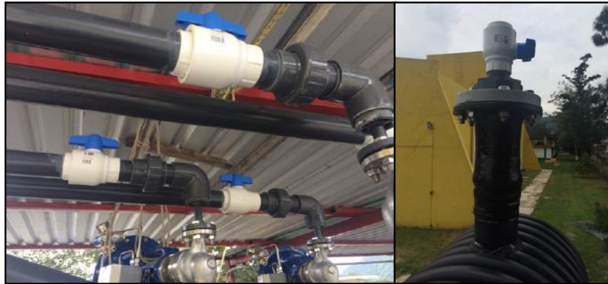
Figura 3.6 Ubicación de válvulas de PVC en tanque de distribución
