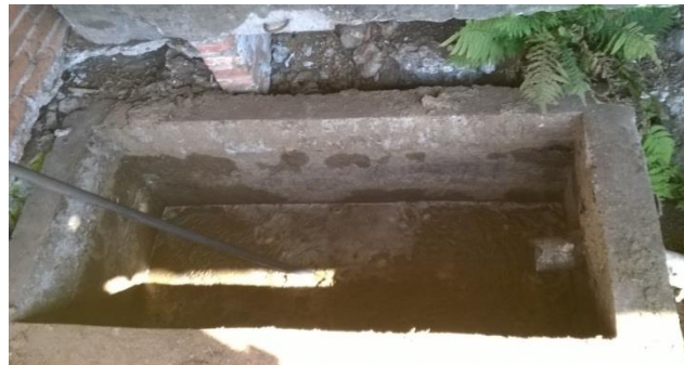
Figura 2.5 Tanque de salida.
