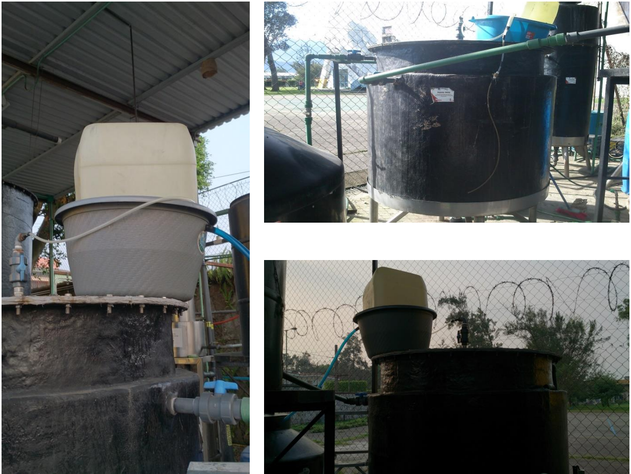
Figura 3.2 Sistema de cuantificación de biogás
